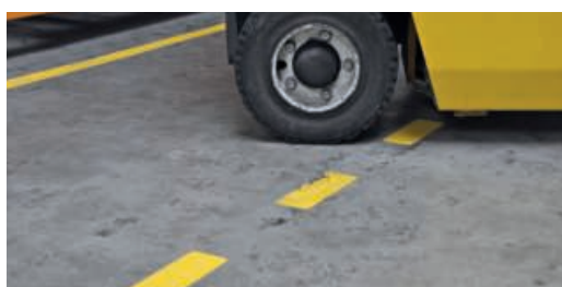
Beschädigung nur an einzelnen Segmenten
